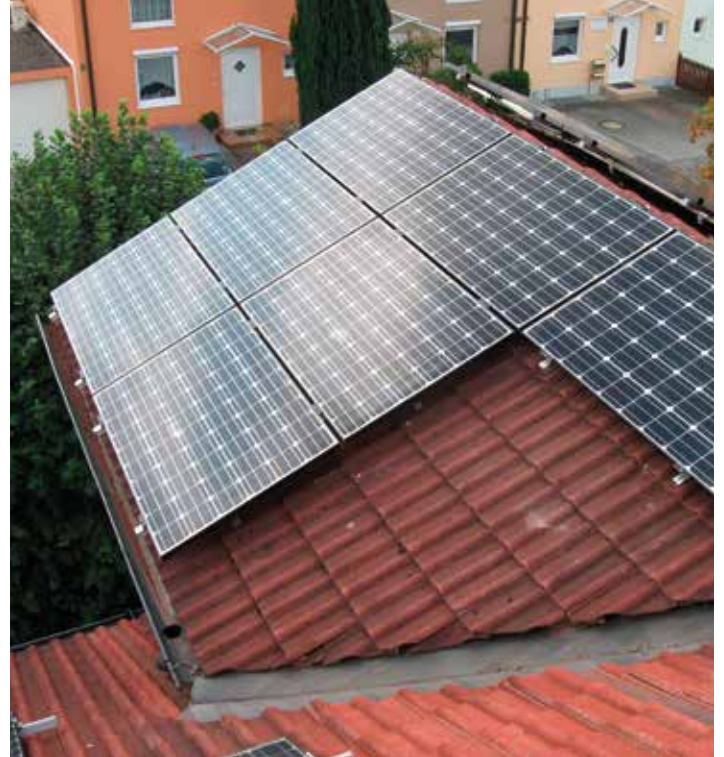
PV-Anlage in Ost- und Westausrichtung
