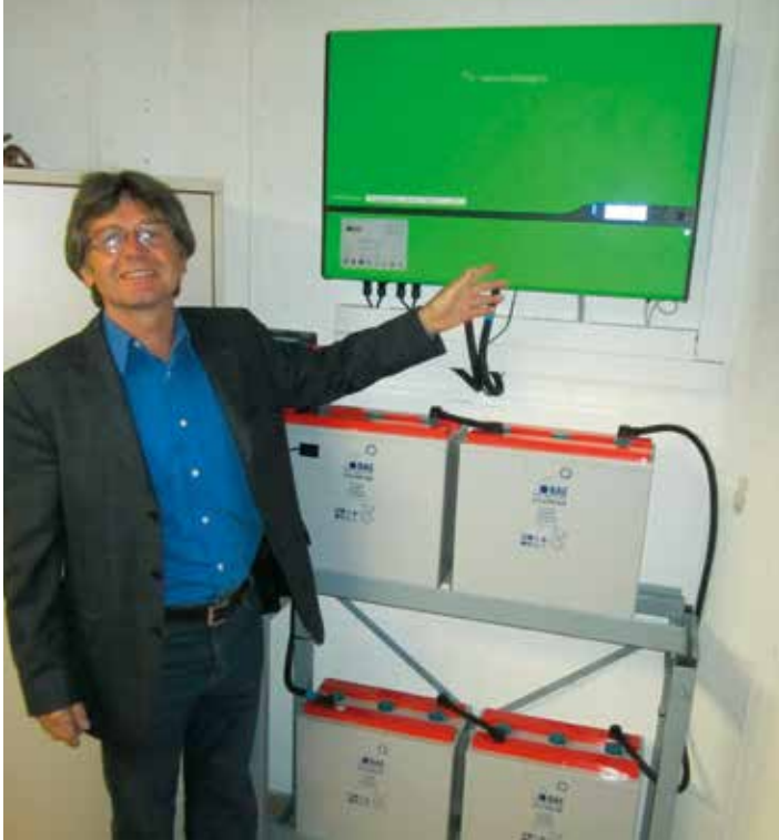
Herr Ecker mit WR und Bleigel-AKKU am Aufstellungsort im Keller
